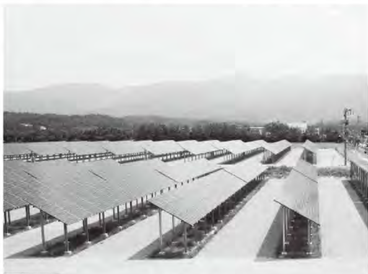
太陽光発電所
