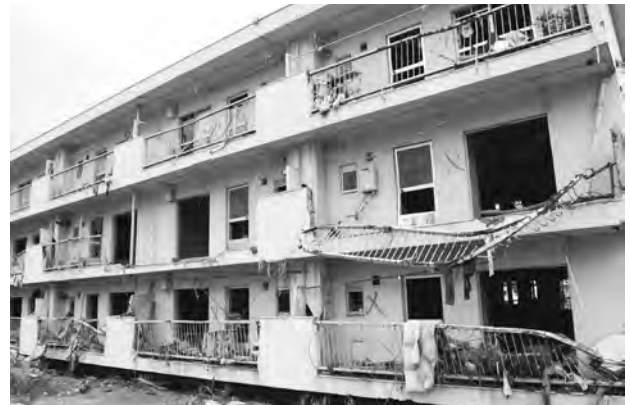
海岸から数キロ地点において、河川に隣接した鉄筋コンクリートの建物が3階まで被害を受けている（釜石市・片岸町）。
