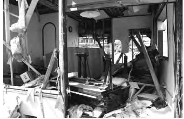
浸水深が2階軒高以下の家屋では流出は免れていた。しかし壁などが破壊され、室内は散乱状態である（宮古市・魚市場）。
