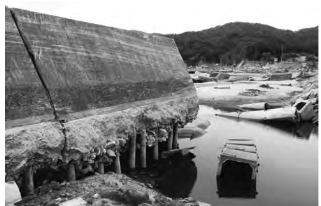
津波を防止するために設けられた防潮堤も波力により一部が転倒し遠くに移動。足元は洗掘されている（岩手県・大槌町）。
