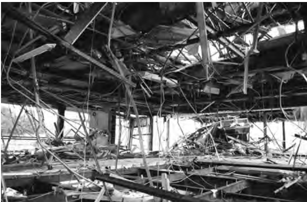
内外装材が全て流出した鉄骨の建物では、柱や梁に掛かる津波の力が小さく、建物の原形を保っていた（岩手県・大槌町）。
