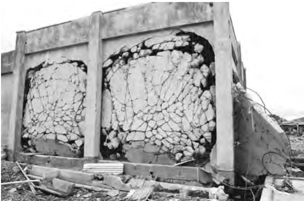
鉄筋コンクリートの建物に侵入した津波が、側面や背面の壁を強く押し、壁は外側に膨らみ破壊している（宮城県・女川町）。
