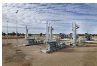
Queensland Curtis LNG Project (CBM Processing Plant)
