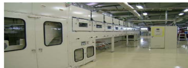
パワーシステム草津事業所 量産設備
