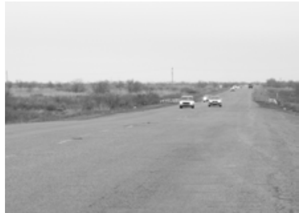
写真3 アルマトイ～ザルカント区間の路面
