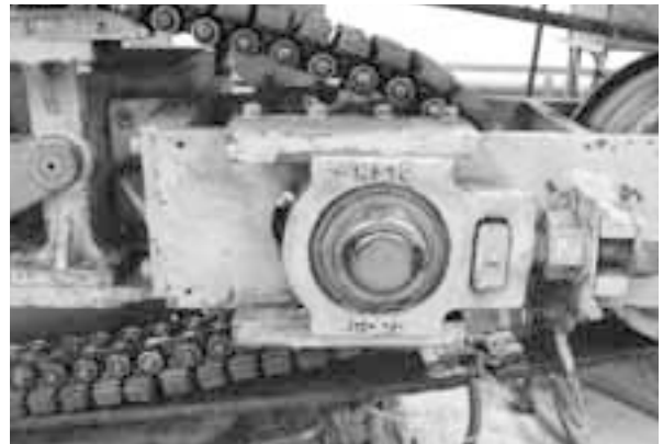
写真8 平壤326電線工場の捲取機（日本製）
