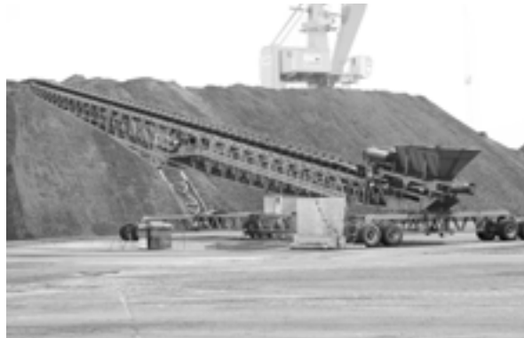
写真5 石炭を積み上げるベルトコンベア
